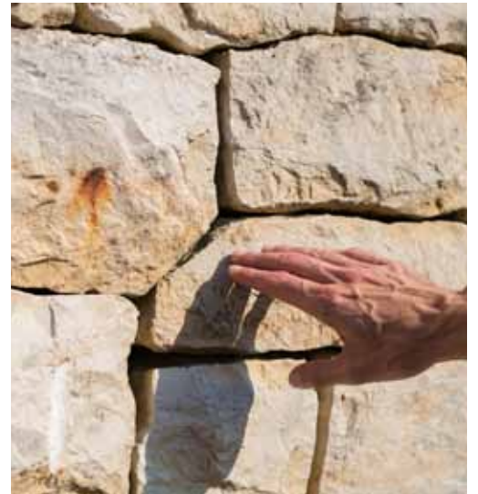
So sieht eine gut gebaute Trockenmauer aus: Versetzte Fugen, gut behauene Steine, genügend Abflussmöglichkeit fürs Wasser.
